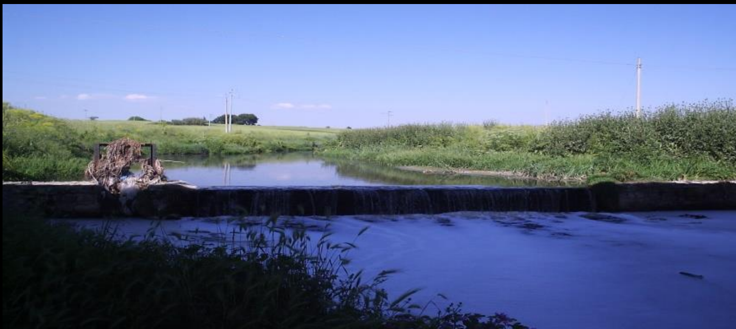
Traversa in località Jesce con impianto di sollevamento mai andato in funzione
